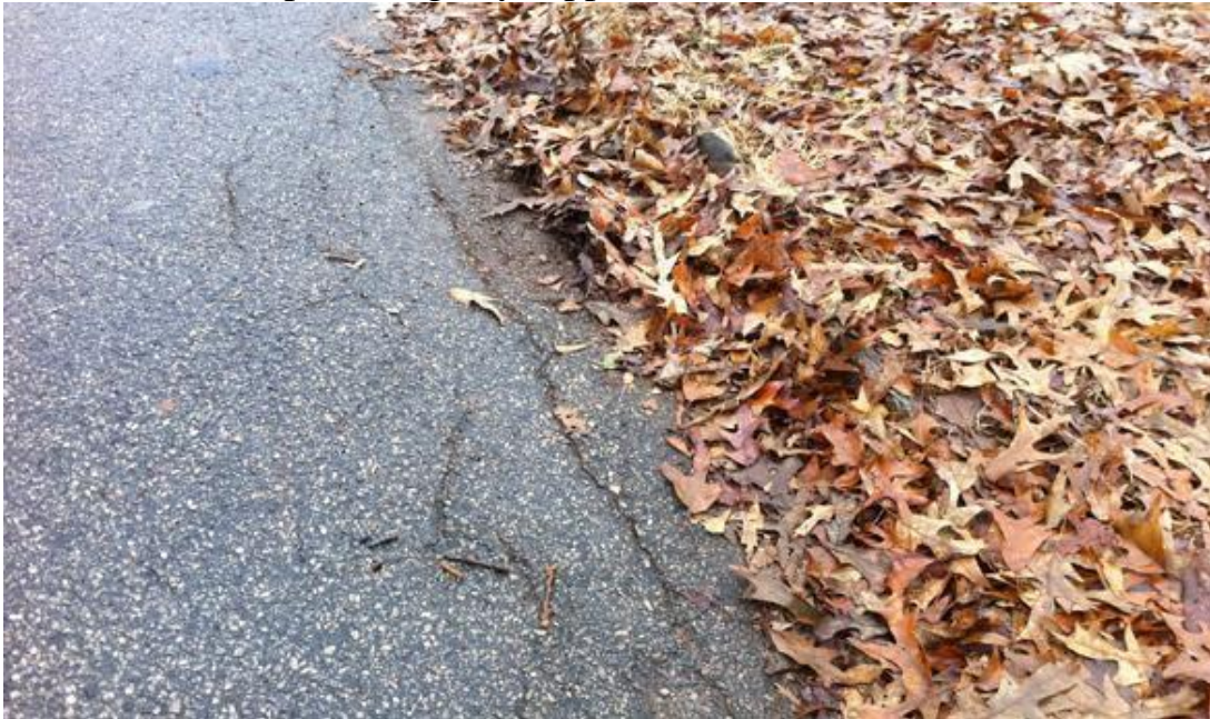
Fig. Edge Cracks
