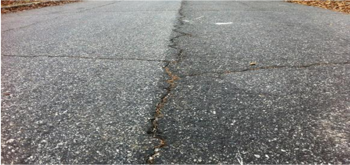
Longitudinal (Linear) Cracking
