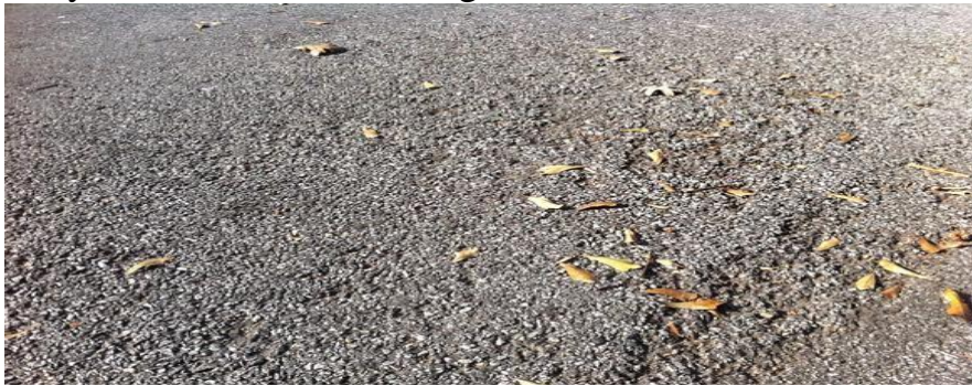
Fig. Raveling (very porous asphalt)
